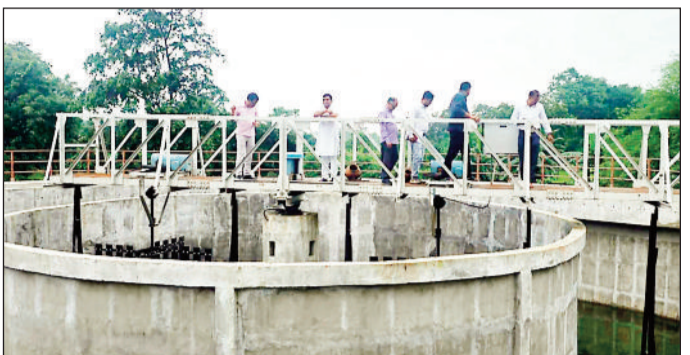
जल आवर्धन योजना के तहत बनाई जा रही पानी टंकी व पाइप लाइन के लिए खोदा गया गड्ढा।
